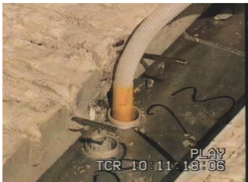
Paßgenaues, geschoßübergreifendes Versorgungs-Rohr für Strom (Quelle: DMPG-Film)
